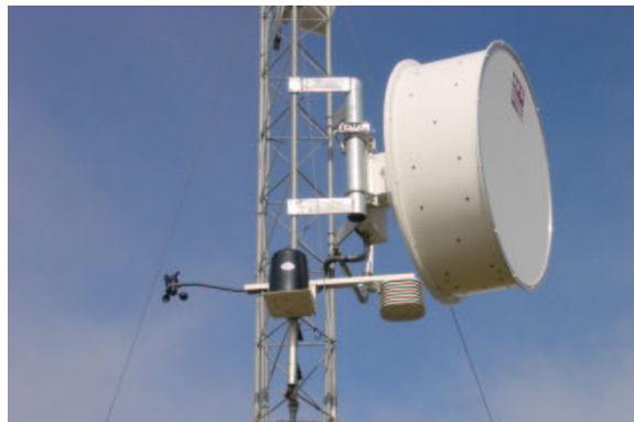
Fig.4: Antena de comunicaciones y estación meteorológica Davis
